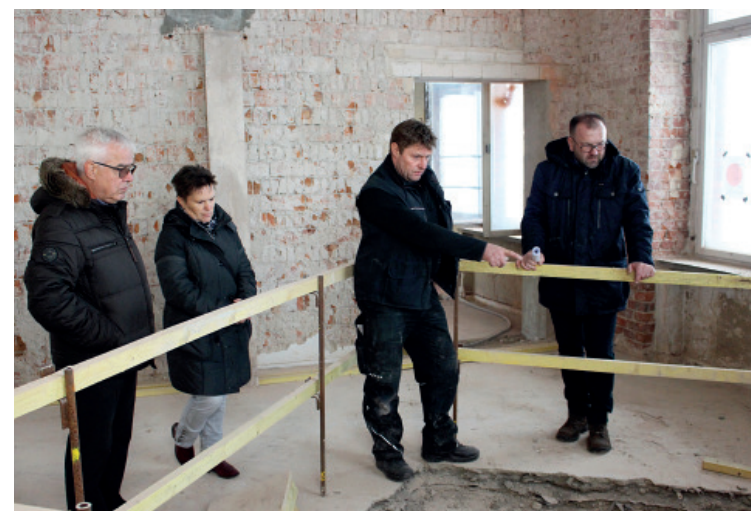
Ab 2004 stand das Gebäude leer, weshalb es in einem schlechten baulichen Zustand war.
